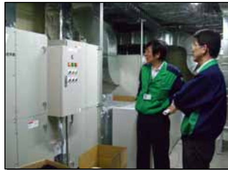
機械室の熱交換システム (ProDeSセンター)
