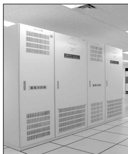
a) UPS 装置
